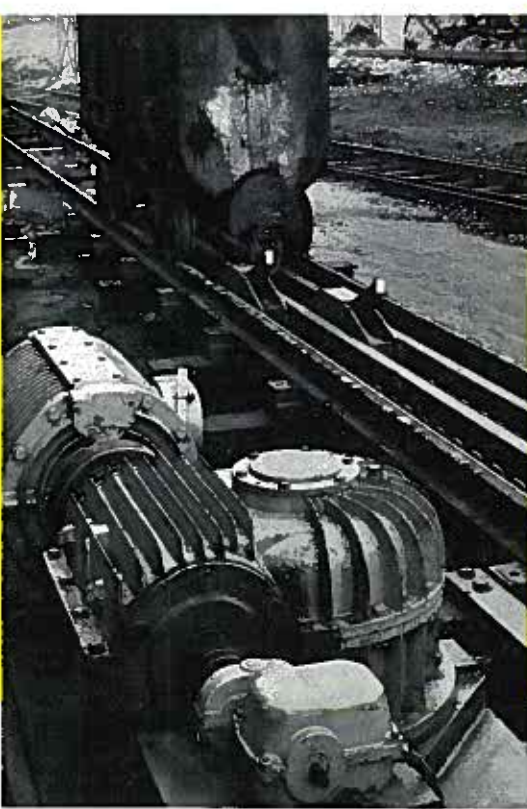
CAVEX-Getriebe Bauart CHVW Größe 250 im Antrieb einer Förderwagen-Vorziehvorrichtung
